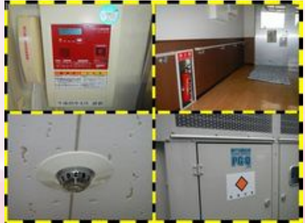
『9月1日は防災の日』～防災設備のご紹介～
